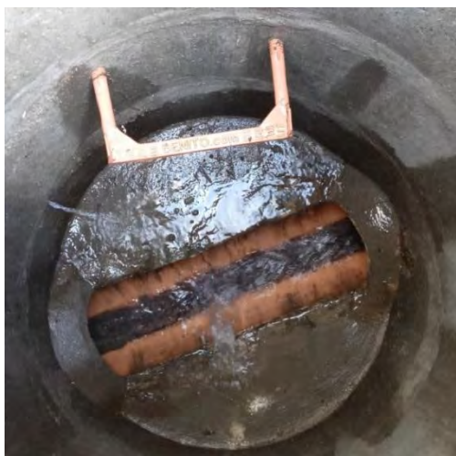
Figura 55: Presencia de infiltracións
