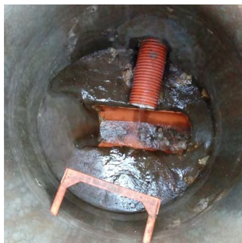
Figura 56: Presenza de acometidas de drenaxe
