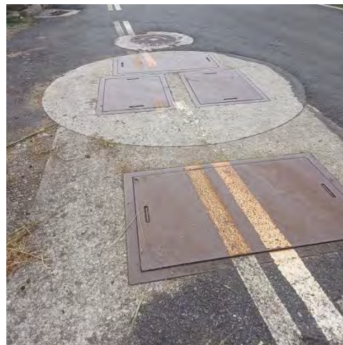
Figura 25: Imaxe do elemento singular EBAR CARRETERA CAMELLE- AROU
