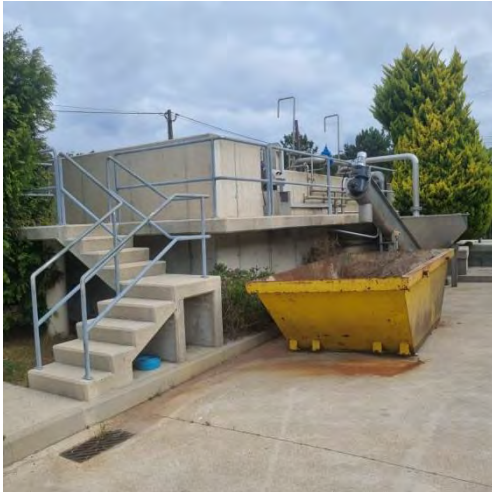
Figura 9: Imaxe do elemento singular EDAR PONTE DO PORTO
