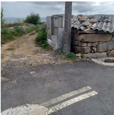
Figura 24: Imaxe do elemento singular EBAR CARRETERA CAMELLE- AROU
