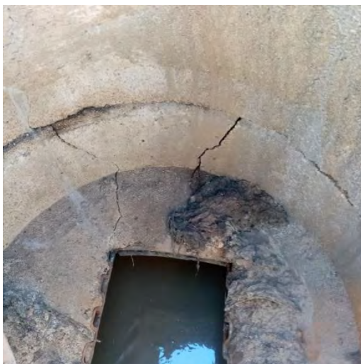
Figura 57: Fisuras en pozos de saneamento.
